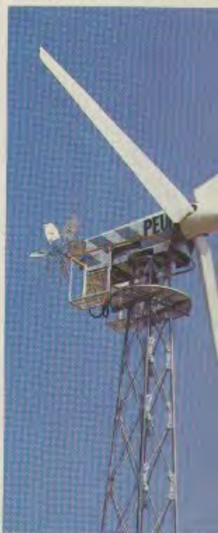
Aerogenerador del parque eólico (Gerona), que consta de seis má
